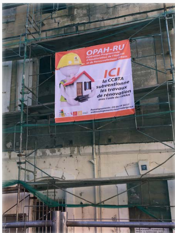
Beaucaire : réhabilitation ayant bénéficié des aides de la CCBTA et de l'ANAH dans le cadre de l'OPAH-RU. Photo : (c) CCBTA
