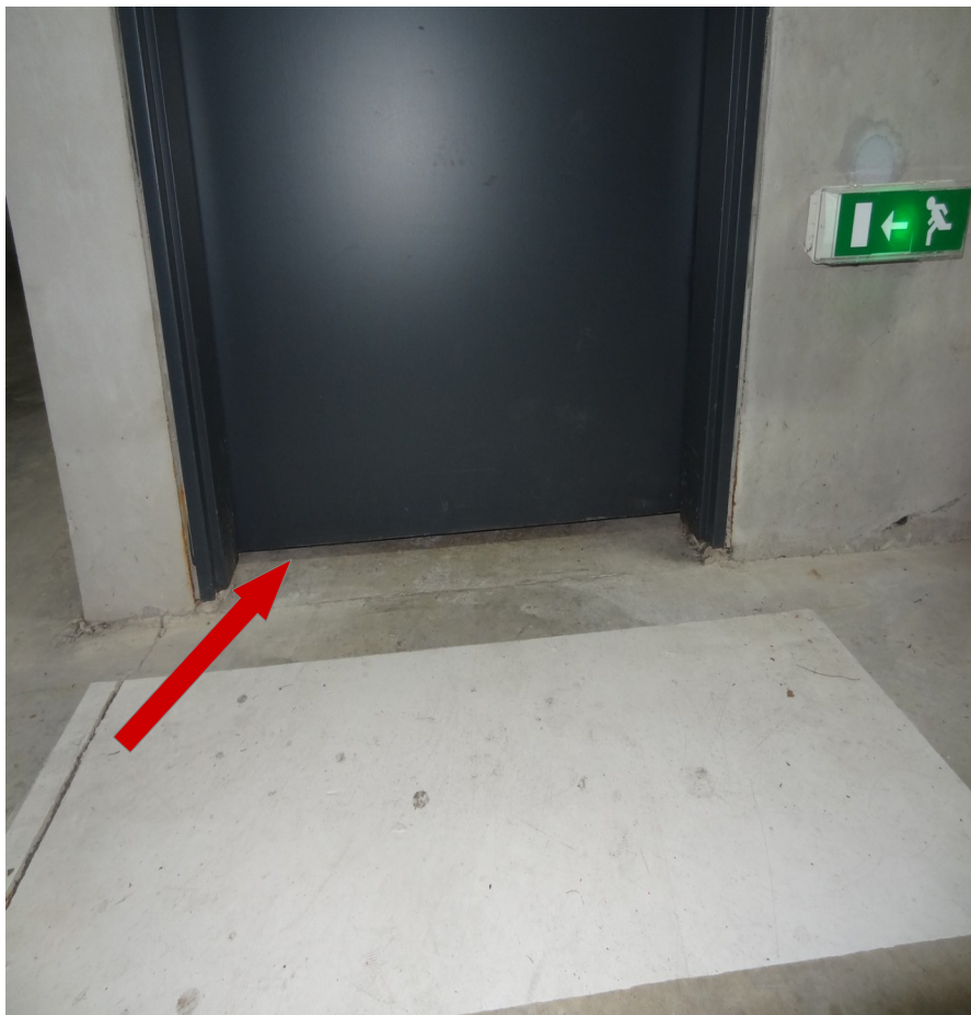
Porte coupe feu trop détalonnée
