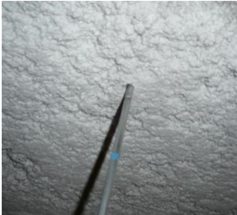
Mauvaise épaisseur de flocage
