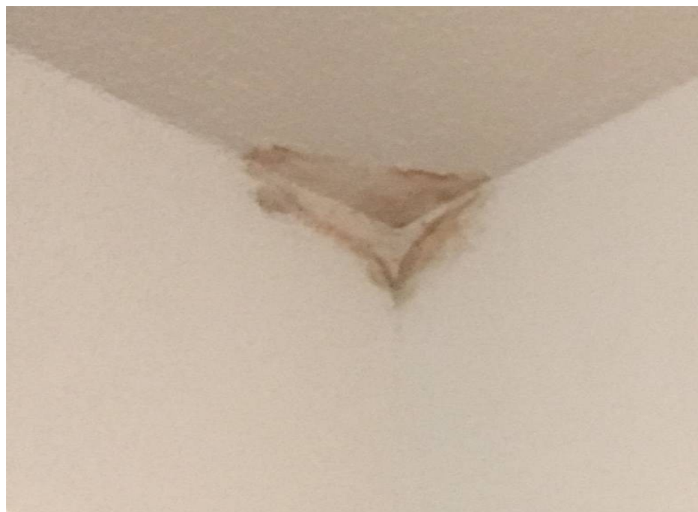
Infiltrations dans logement
