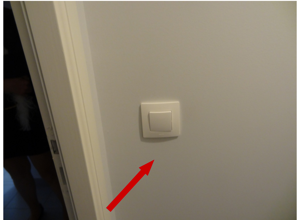
Absence de prise électrique à proximité immédiate de l'interrupteur
