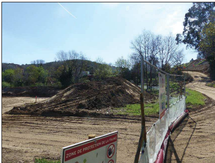
Exemple de dispositif anti-intrusion sur un portail d'accès
