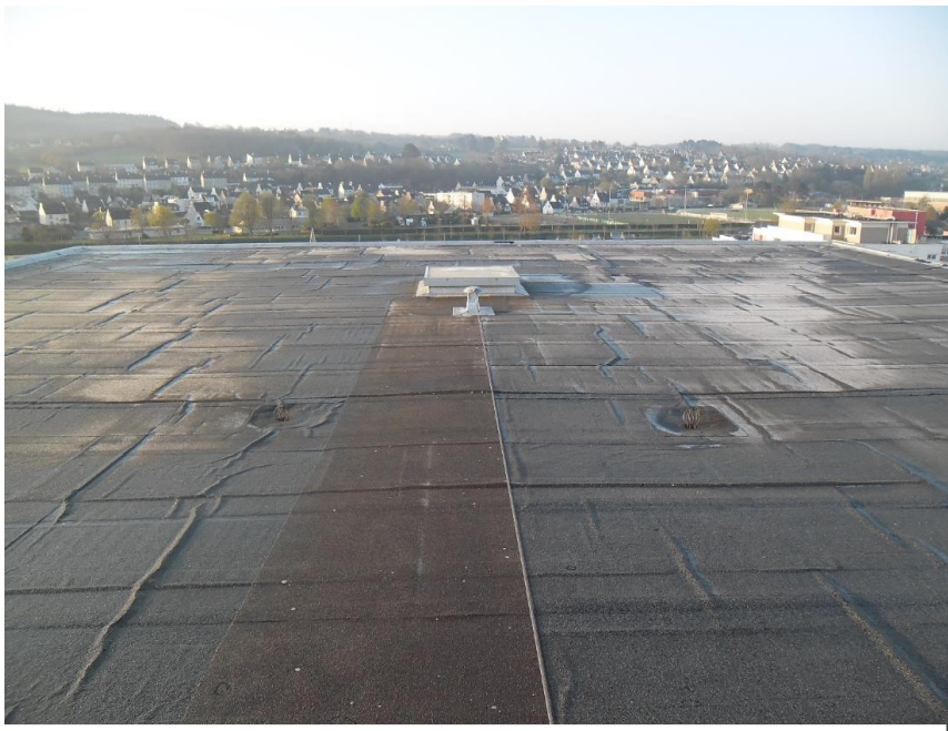
Plissements de l'étanchéité - Reptation du complexe
