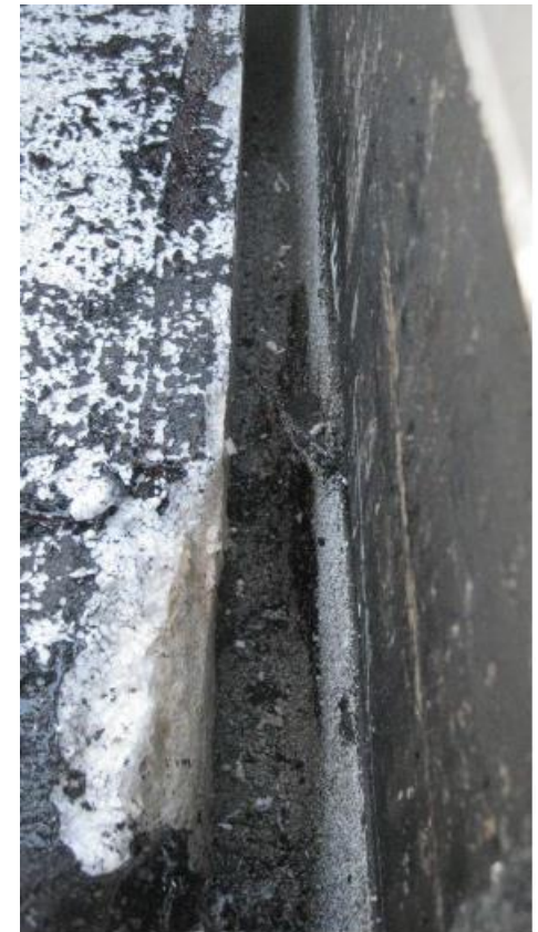
Rétraction cumulée de panneaux isolants en polystyrène en pied de relevé
