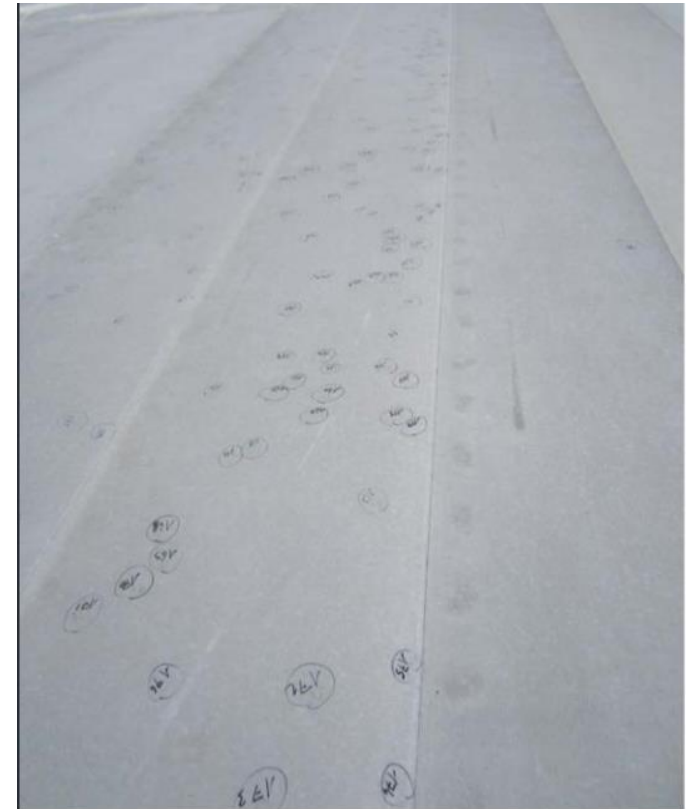
Impact de grêle sur membrane d'étanchéité en PVC (source : Eurisk)
