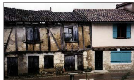
Flamarens, habitat urbain dégradé
