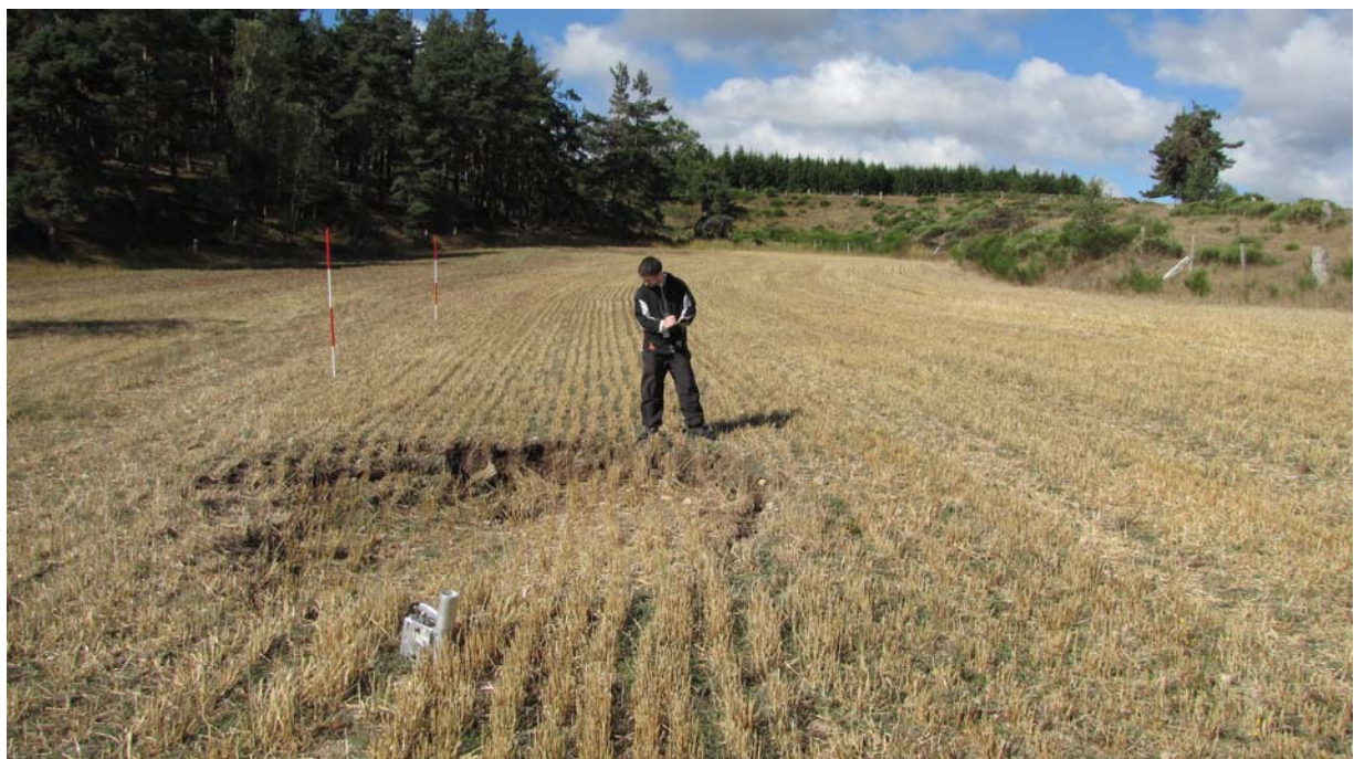
Tassement récent au droit de l'ancien puits de recherche (septembre 2010)
