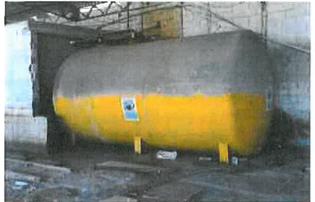
Cuve de gasoil de 40000 L dans le bâtiment Ouest
