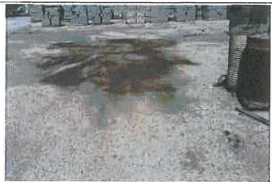
Dalle de béton souillée à proximité de la pelle mécanique
