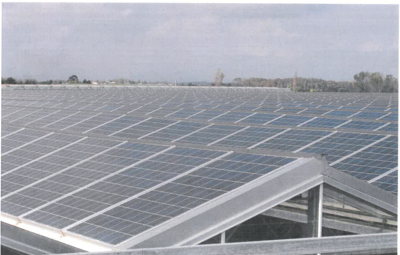
→ TOITURE D'UNE SERRE. PAN DES PANNEAUX PHOTOVOLTAÏQUES
