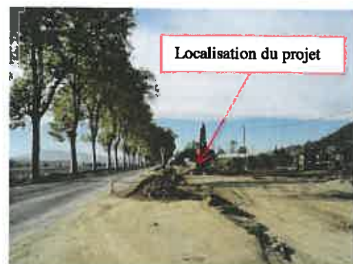
- Photo n°6 : Vue sur les travaux en cours du PRAE Charles Cros (Projet : Localisation du futur tracé de la nouvelle voie de desserte, à droite des travaux)
