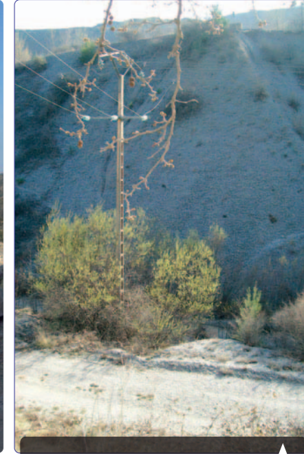
▲ Ligne électrique qui passe entre la zone des bureaux et la zone d'extraction
