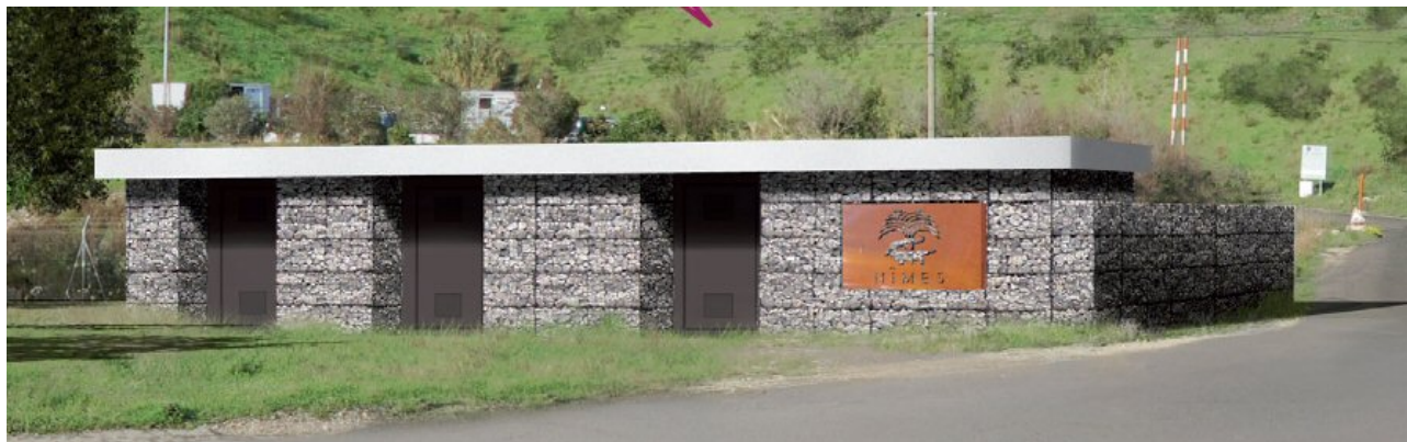
☞ Photographie 1 : Poste de livraison proposé
