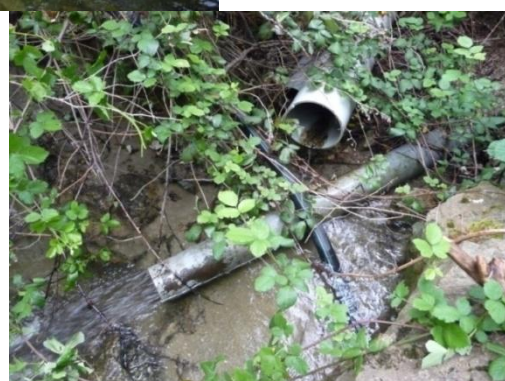
Figure 28 : Canalisation d'évacuation du désableur
