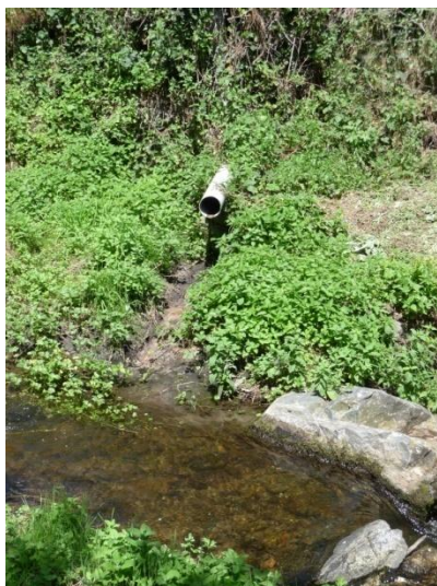
Figure 17 : canalisation de rejet
