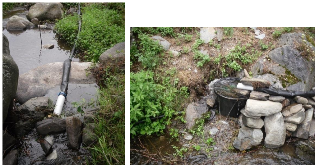
Figure 44 : Tuyau en plastique conduisant l'eau dans une poubelle.
