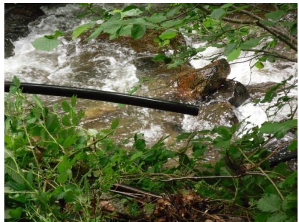
Figure 10 : Tuyau de captage trouvé dans la rivière.
