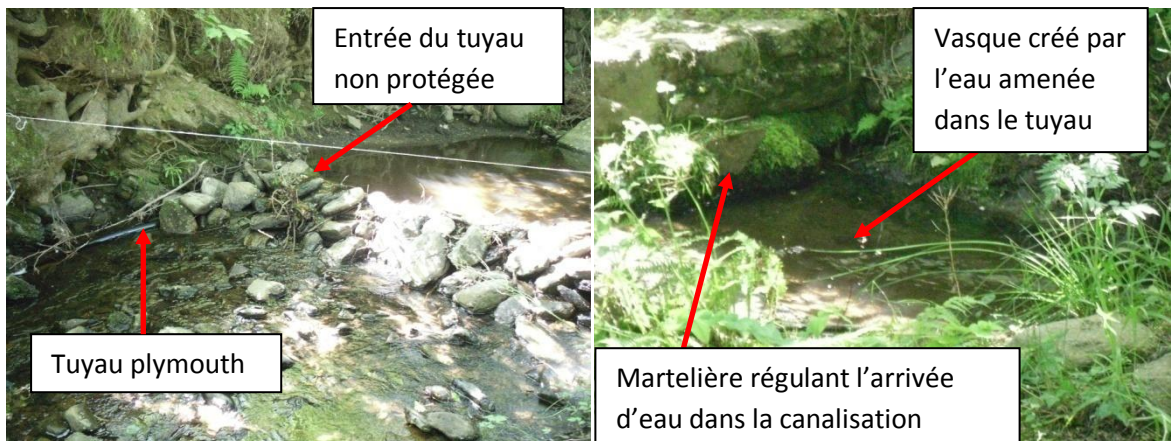
Figure 43 : dispositif de captage en deux parties.
