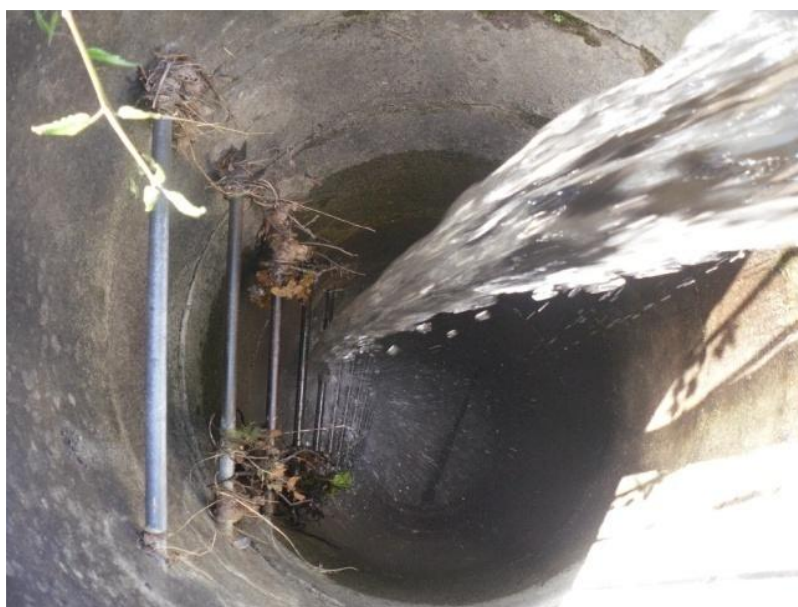
Figure 58 : Chute importante sur le canal 88.
