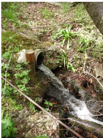
Figure 18 : rejet du trop plein d'eau d'un réservoir
