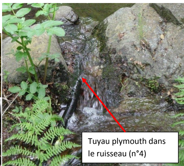
Figure 33 : Tuyau plymouth non protégé au milieu du ruisseau
