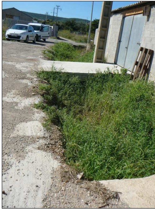
Photographie du fossé à l'amont immédiat du passage sous la voie ferrée, c'est-à-dire à l'aval de la globalité du bassin-versant urbanisé...
