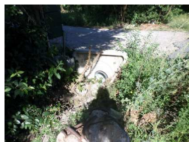
Figure 32 : Buse en Ø300 insuffisante (ouvrage 46)
