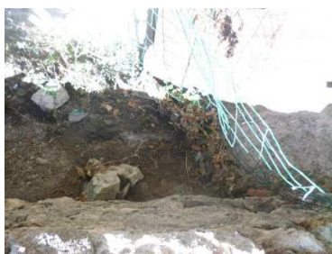
Figure 31 : Fossé de capacité insuffisante
