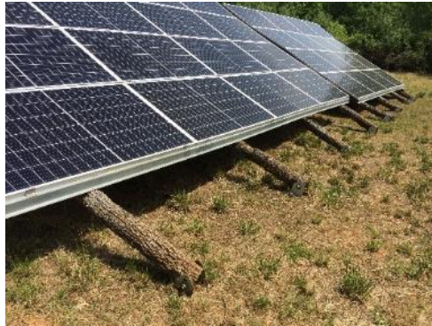
parc photovoltaïque citoyen
