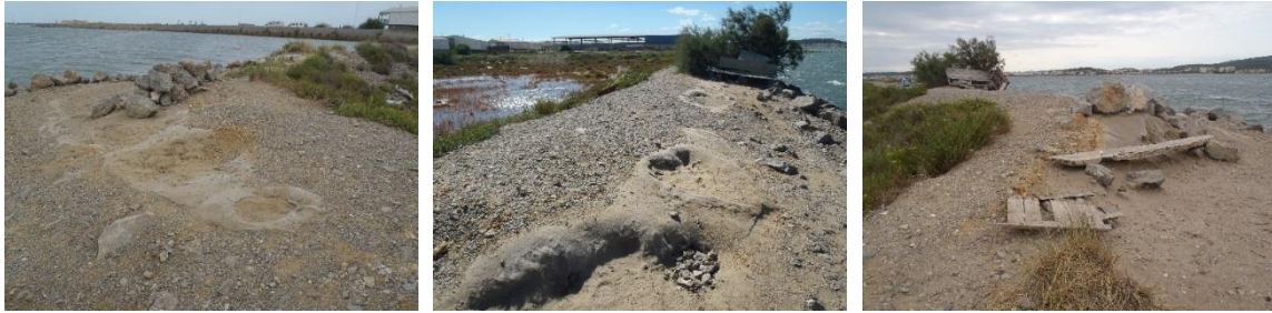
Fig. 25 - Bassins tampons – Endiguement dégradé par les pêcheurs de loisir (av.2014 et 2016)
