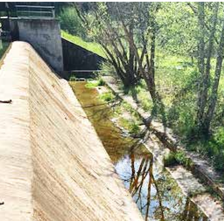
Évacuateur de crue du barrage du lac vert à Catus (Lot) - photo DREAL Occitanie
