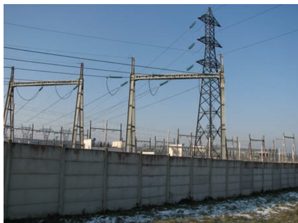
Poste électrique de Verfeil.
