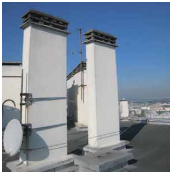
Conduits de ventilation naturelle
