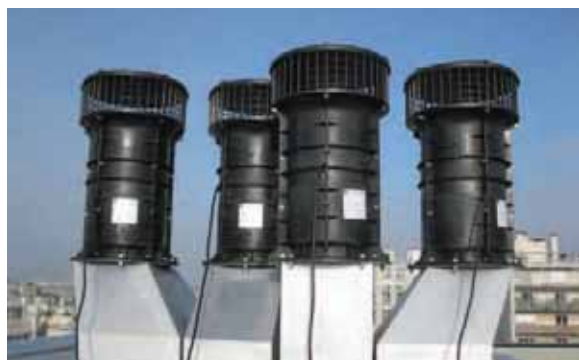
Conduits de ventilation naturelle assistée
