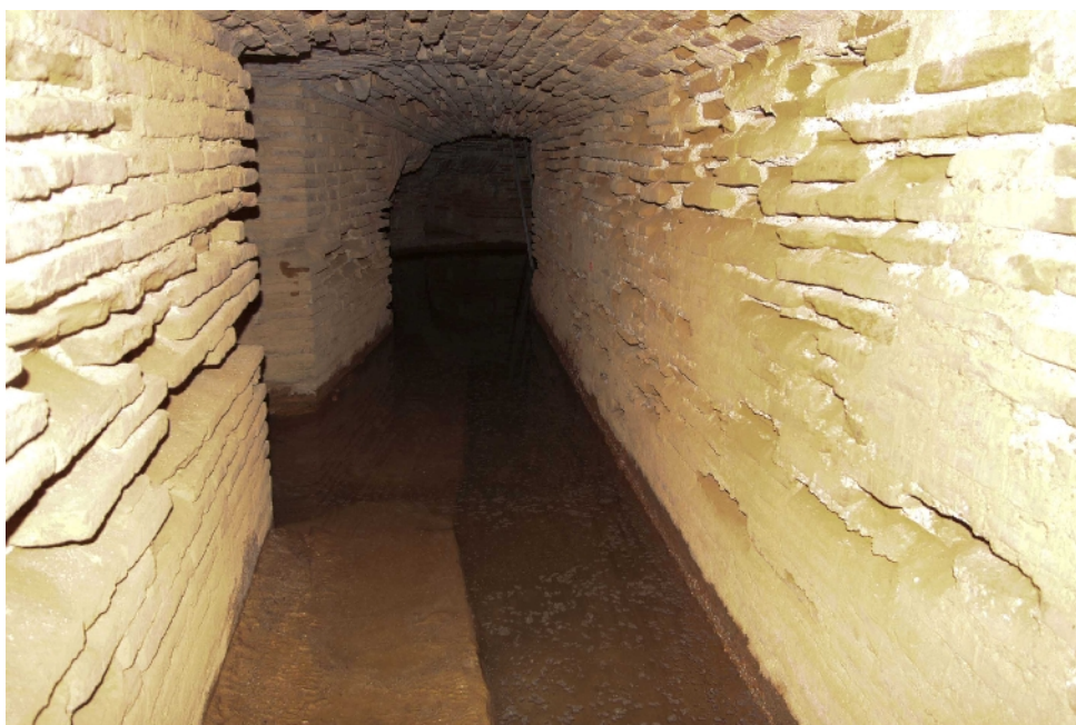
Figure 3: Souterrains de la tour Nord Ouest et de la caponnière Nord Ouest inondés de plus de 40 cm d'eau en juillet 2009. Les eaux ont été présentes de novembre 2008 à juillet 2009 au moins (V. Rufray).
