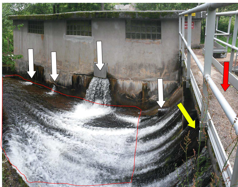
Figure 37 : Vue de la partie aval du captage d'eau des Brasses.
