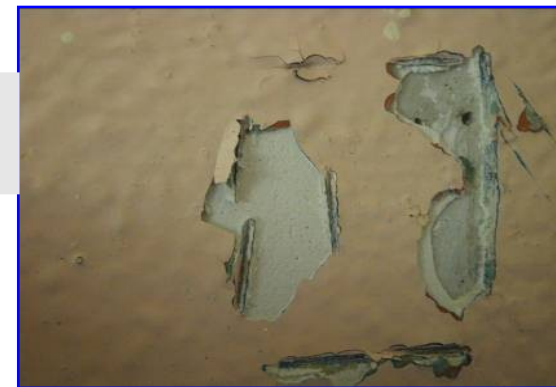
Enduits plâtre anti-bullage amianté
