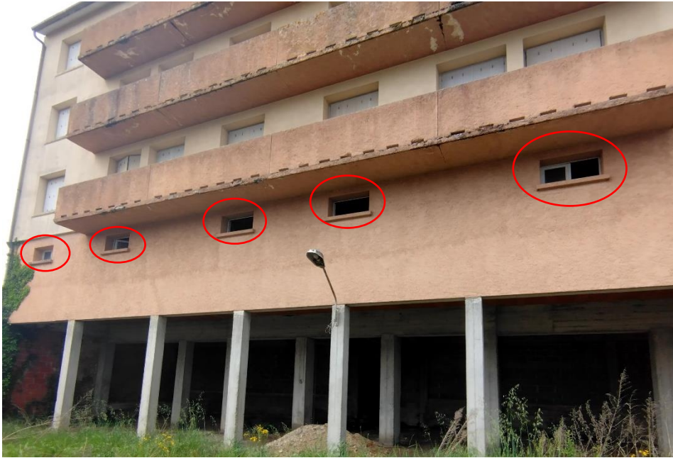
Figure 4 : Du « guano » (excréments des chauves-souris) a été retrouvé en plusieurs tas dans chacune de ces pièces (voir photos ci-après)
