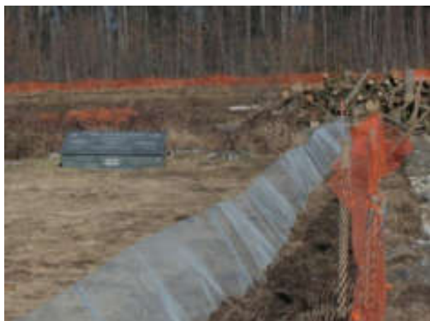
Double grillage de protection isolant la zone humide du reste du chantier (ici au niveau du monument aux morts
