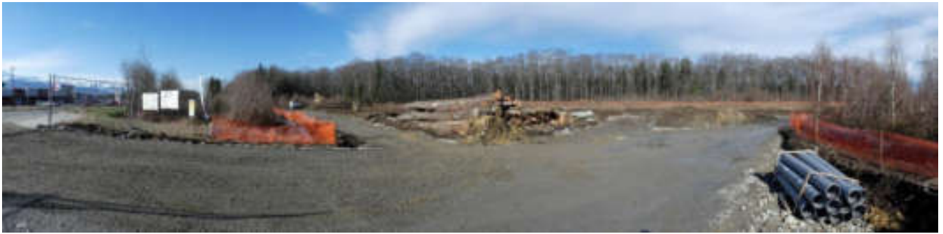
Le site d'étude en janvier 2017 : le grillage orange à gauche et à droite de l'image délimite les deux surfaces de zone humide mises en défens ; le reste du site est défriché et en partie stabilisé
