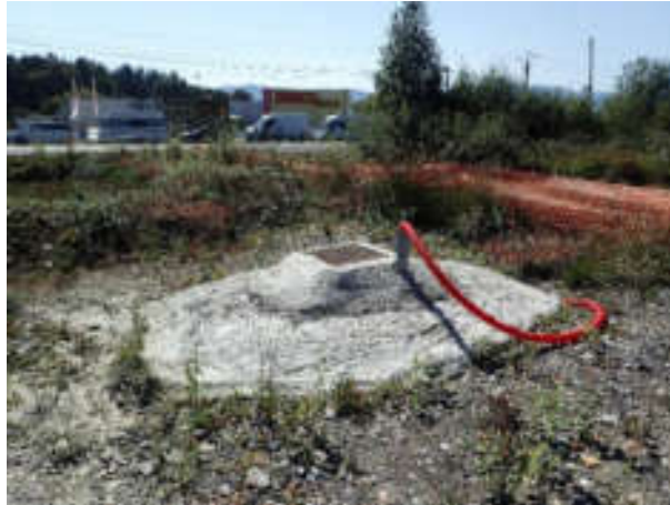
Accès au dispositif antipollution en sortie d'un bassin d'orage, en amont de la zone humide
