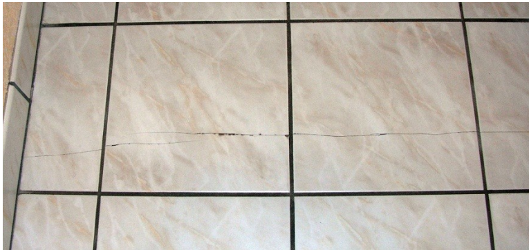
Les fissures affectent les surfaces courantes
