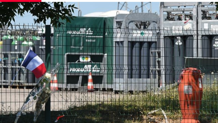
Saint-Quentin-Fallavier (Isère) 26 juin 2015 - Air Products (Seveso SB)
