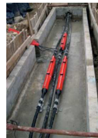
Figure 5 : Exemple de chambre de jonction
