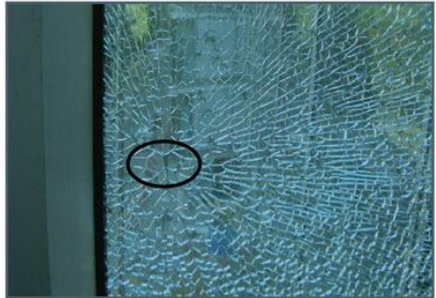
Rupture typique au départ d'une inclusion de NIS
