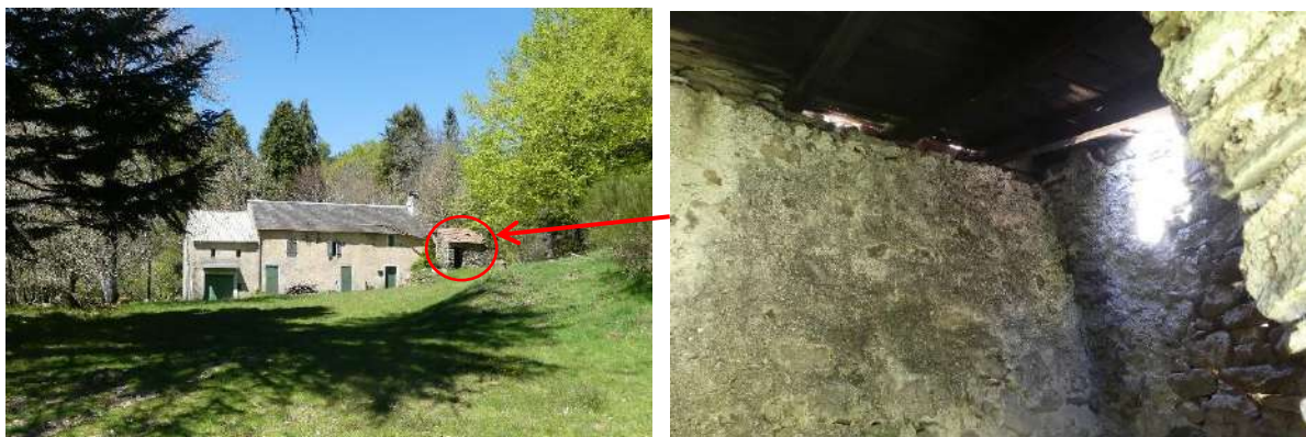
Figure 17 : Maison forestière du Crouzet et entrepôt en pierre présentant de nombreuses failles et anfractuosités favorables aux chiroptères, L. VINCENTI © EODD, 2020
