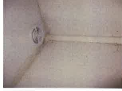
Grille d'extraction d'air dans la cuisine non fonctionnelle
