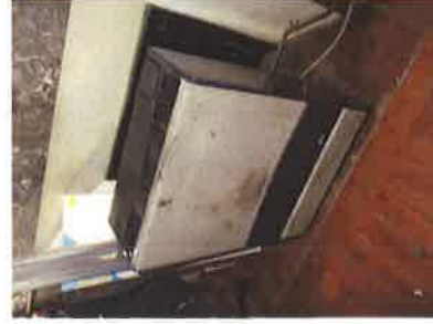
Appareil de chauffage gaz avec son évacuation des gaz brulés par le foyer traversant le rideau
