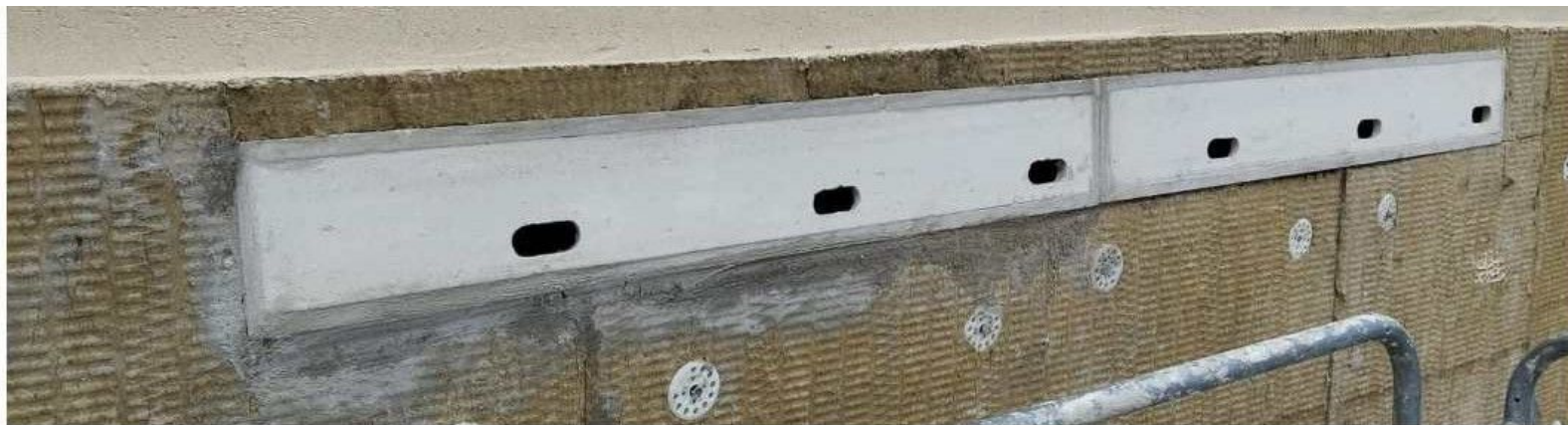
Intégration de nichoirs triples à martinets sur le site pilote d'Orly © Elsa Caudron
