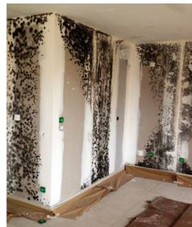
Développement important de moisissure dans un bâtiment sans ventilation..
