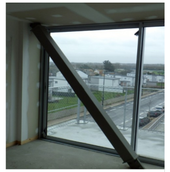
Buton métallique placé en travers d'une baie vitrée coulissante empêchant l'accès au balcon.
