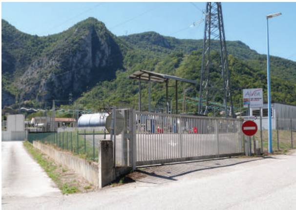
410. Tarascon-sur-Ariège / centrale électrique
