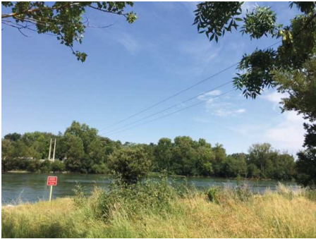
Ligne aérienne traversant la Garonne à Portet
