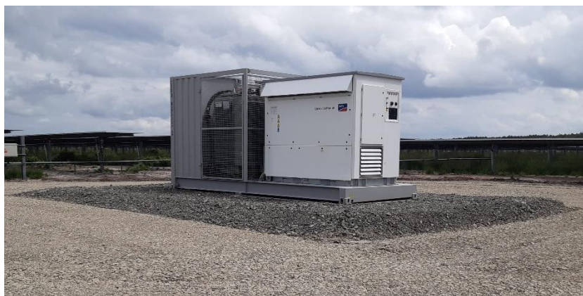
Exemple d'un poste de transformation « outdoor »
