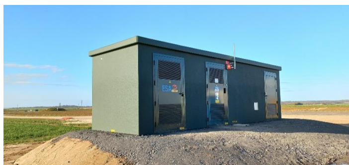
Exemple de poste de livraison
