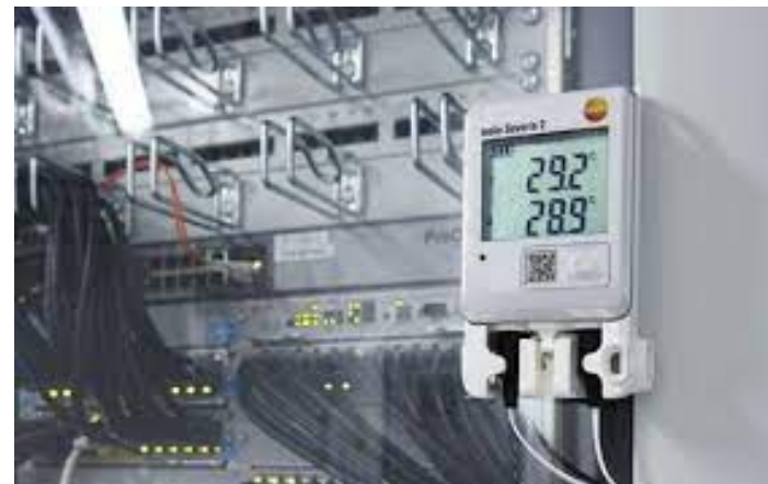
Augmenter la consigne de climatisation des salles serveurs
