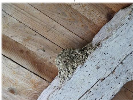
Nid d'Hirondelle rustique sous plancher (bât. 1)
