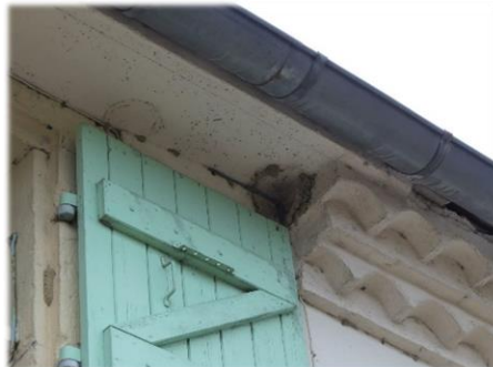
8. Reste de nid isolé sur embrasure de fenêtre de la façade sud-ouest
