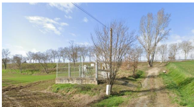
Figure 25. Photos – Poste de sectionnement de Gémil
