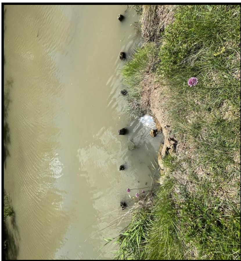
Illustration de l'érosion conséquente de la berge. L'abattage des platanes et donc la dégradation progressive des systèmes racinaires laissés en place aggraveront aussi l'état des berges en l'absence de mesures.
