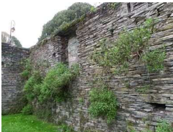
Désordres sur parement aval © DREAL Pays de la Loire
