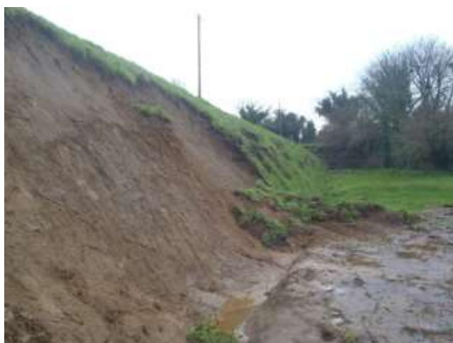
Glissement du parement amont sur un perré en pierres sèches - EISH de type incident déc. 2022 Barrage de Beffou (22) ©DREAL Bretagne - Olivier ORHANT – janvier 2023
