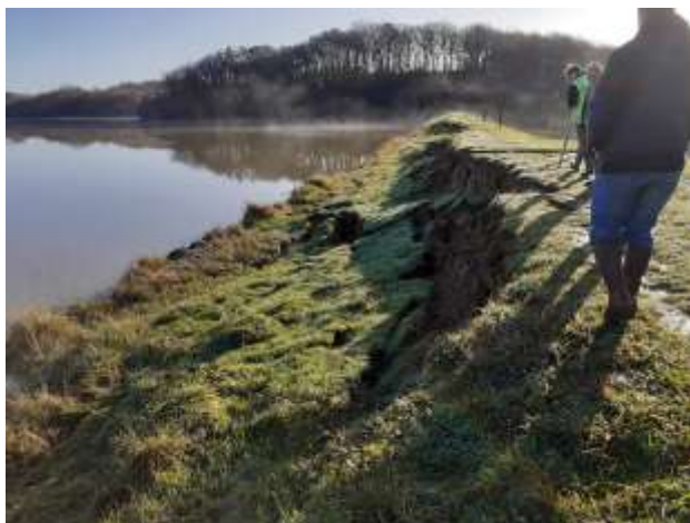
Glissement du parement amont d'un barrage sur la commune de Saint-Laurent-de-Gosse (Nouvelle-Aquitaine, novembre 2022) © SCSOH Nouvelle-Aquitaine
