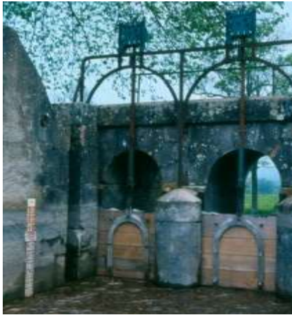
Vannes plates à glissières entretenues © DREAL Pays de la Loire
