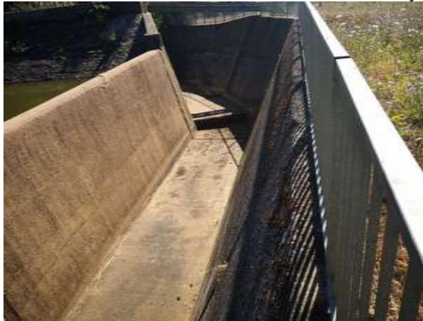
Déversoir entretenu © DREAL Pays de la Loire
