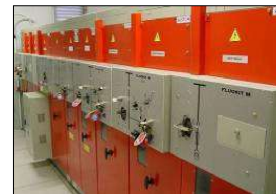
Figure 9 : Cellules électriques du poste de livraison (source : CNR)
