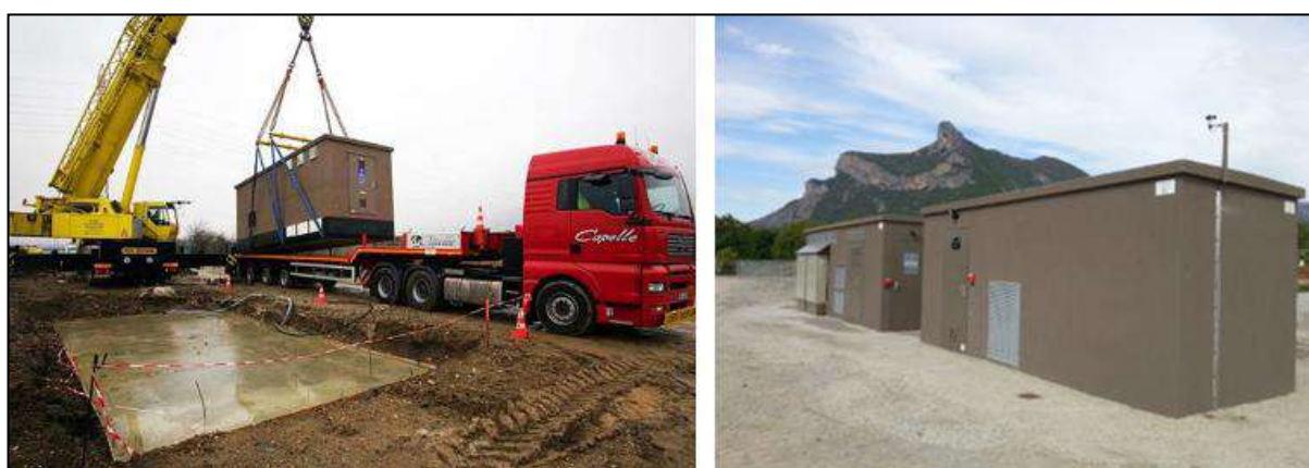
Figure 8 : Installation de postes de livraison et de transformation
