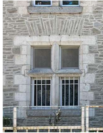
Croisée pierre avec chambranle harpée et plate bande de décharge en appareillage irrégulier
