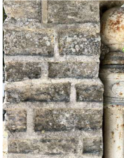
Pilier de portail avec joint épais
