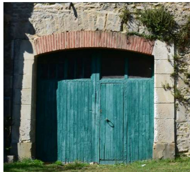
Arc segmentaire brique sur sommier pierre avec arc de décharge en pierre
