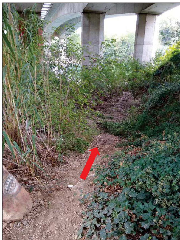
Figure 22 : Visuels du chemin piéton existant en pied de piles P1 (source : Arcadis MOE PRO, 01/10/2020)
