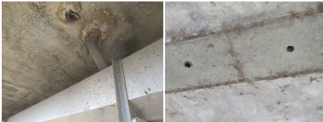
Figure 25 : A gauche présence de guano sur le caisson métallique situé sous le drain ; à droite drain entre les caissons favorable.
