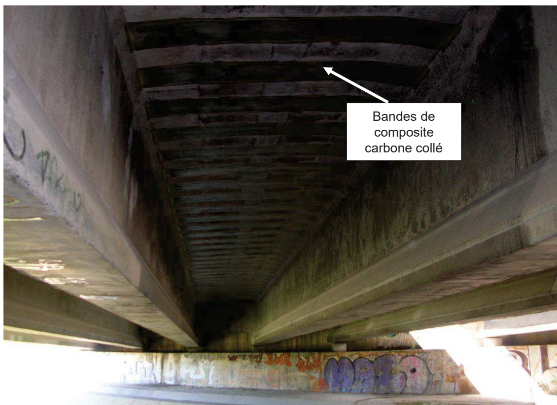
Figure 10 : Exemple de hourdis de pont renforcé par tissu en composite carbone collé entre poutres (source : Arcadis MOE PRO)
