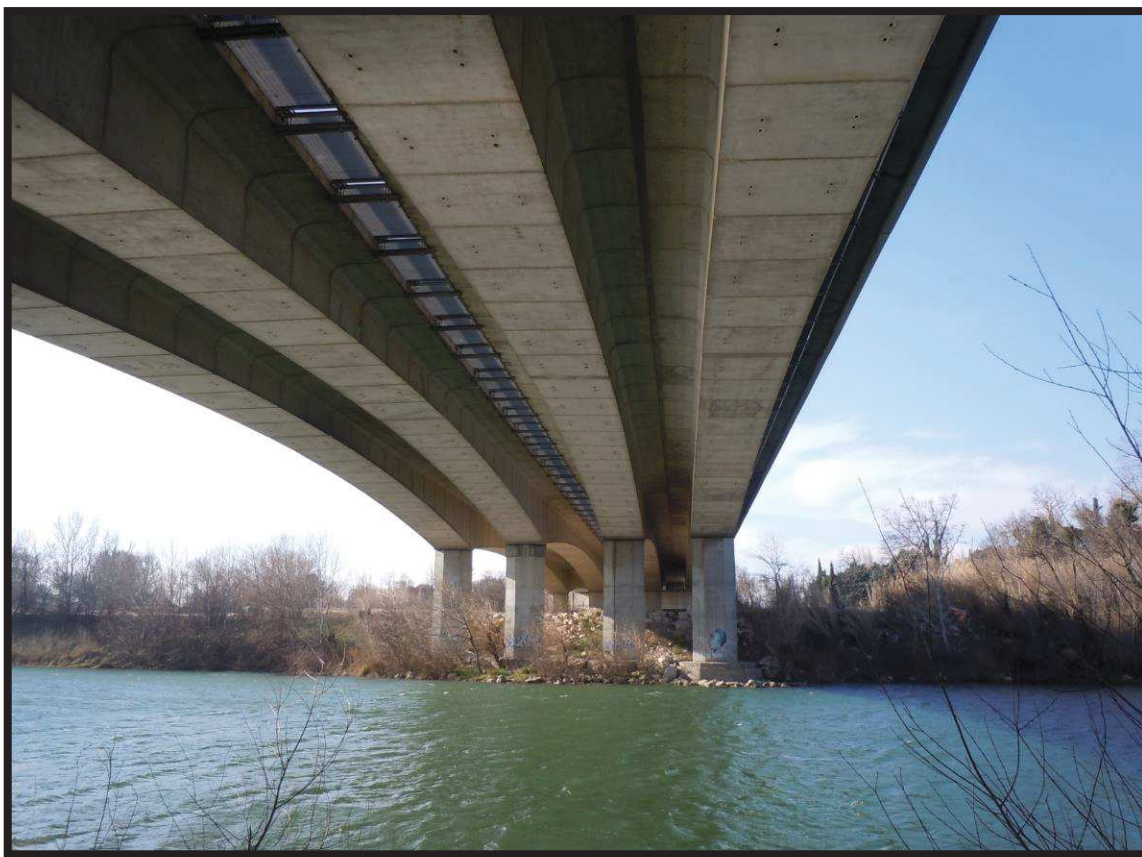
Figure 3 : Vue de l'ouvrage depuis la berge en rive gauche (source : Arcadis MOE PRO, 01/10/2020)
