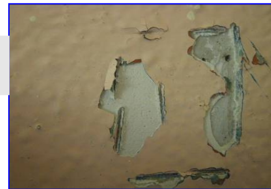
Enduits plâtre anti-bullage amianté
