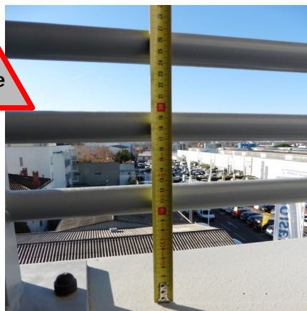
Effet d'échelle car le dernier barreau horizontal est situé à moins de 45 cm.
