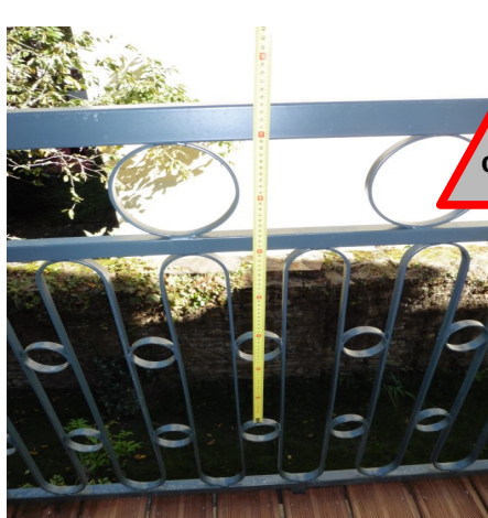
Effet d'échelle car l'appui (cercle métallique) diminue la hauteur de garde-corps à moins de 1 m.
