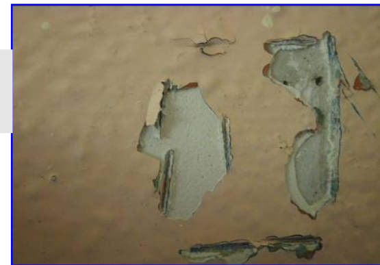
Enduits plâtre anti-bullage amianté
