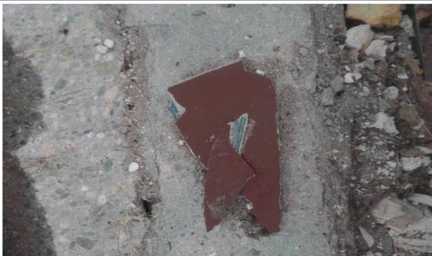
Prélèvement - P001 : RDC / Dallage - Plaque- (Présence d'amiante)
