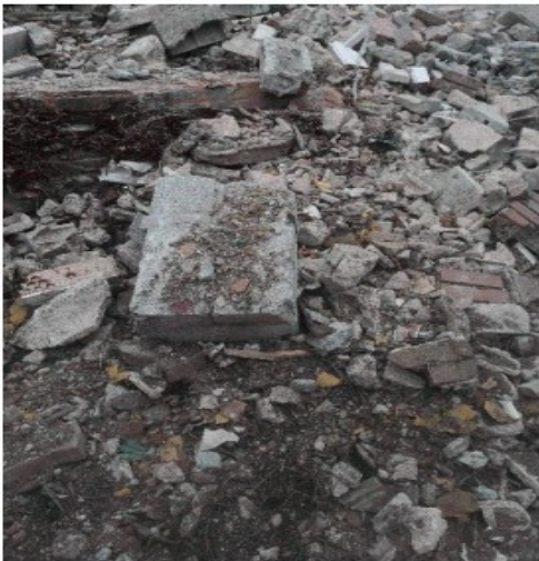
prélevé - idem P001 : RDC / tas de gravats 1 - Plaque- (Présence d'amiante)
