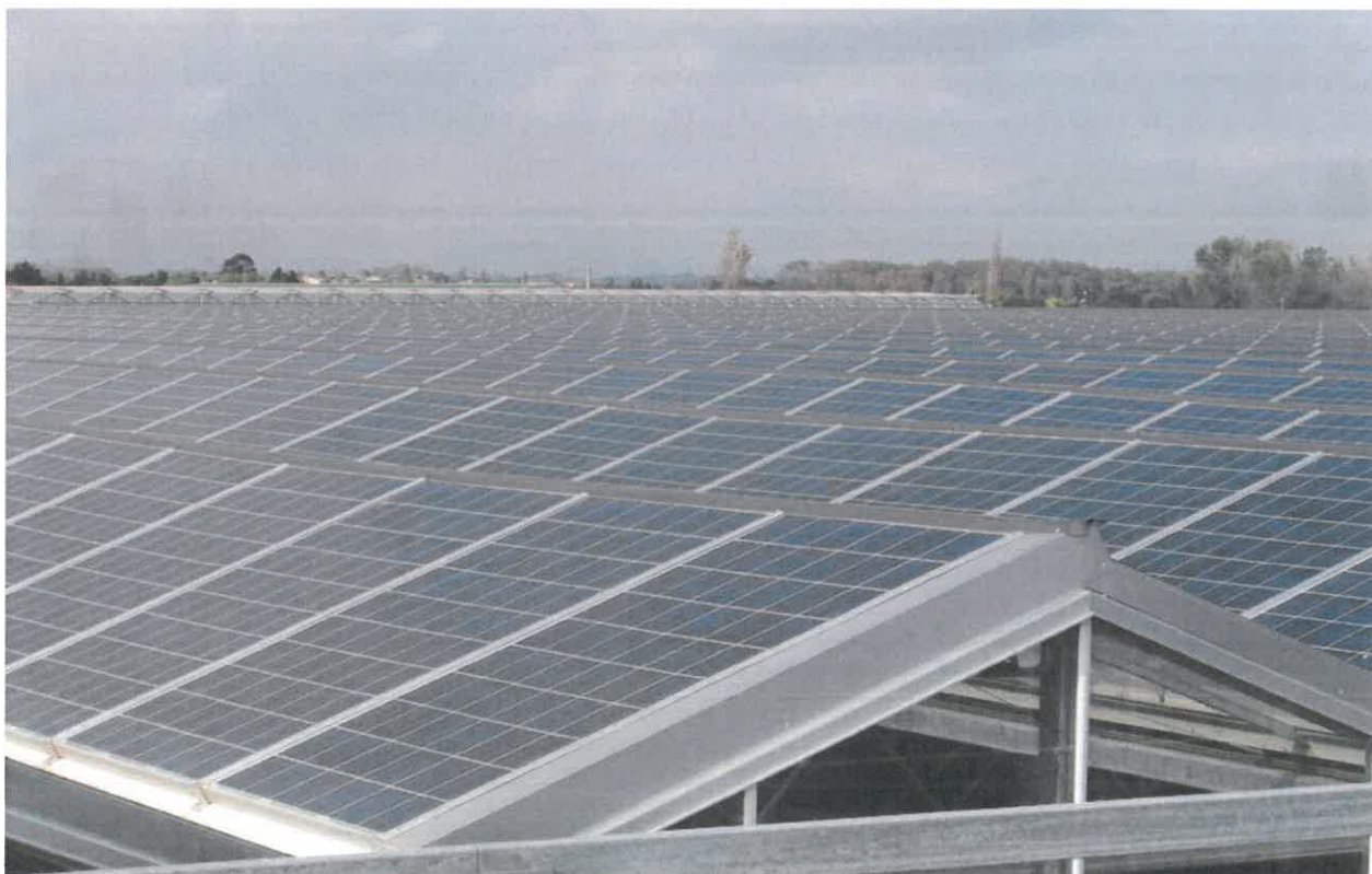
→ TOITURE D'UNE SERRE. PAN DES PANNEAUX PHOTOVOLTAÏQUES
