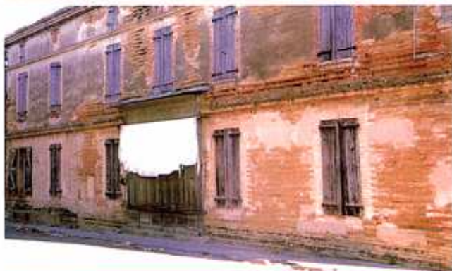
Deux exemples de bâtiments brique crue à Grisolles, en mauvais état
