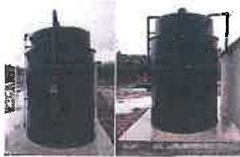
NOUVELLE CUVÉ SOUDE De 5000 l
