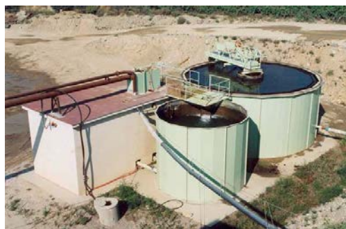
Traitement des boues
