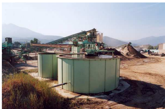
Clarificateur des eaux
